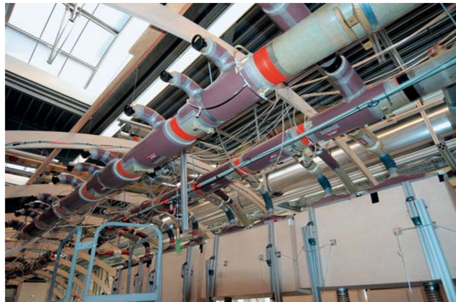
Wie viel Luft kommt aus welcher Düse? Originale Rohre des Air-Conditioning- und Belüftungssystems, zu Testzwecken aufgehängt in einem Holzskelett, das der Rumpfkontur entspricht
